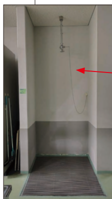
7号館環境実験室 緊急シャワー チェーンをひくと水が出ます
