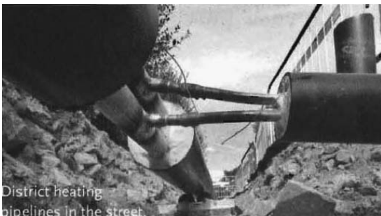
図 12 VEAB の温水断熱配管
