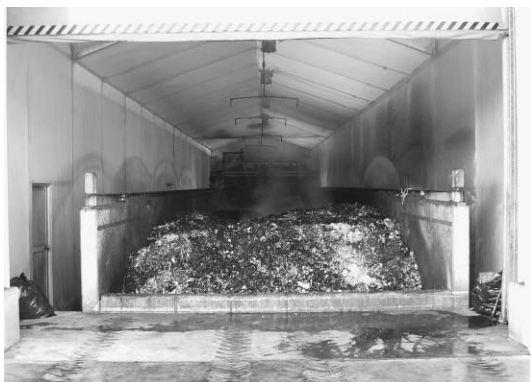
図4 直線スクープ式堆肥化施設
